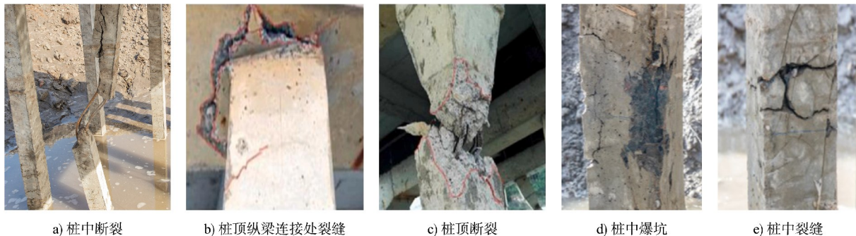
图 18 桩基典型破坏现象
