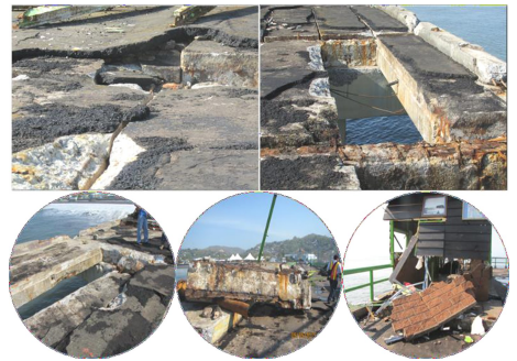
图3 码头损坏现状
