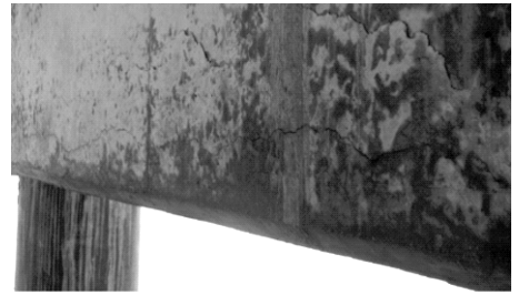
图 8 横梁中钢筋锈胀劣化照片
