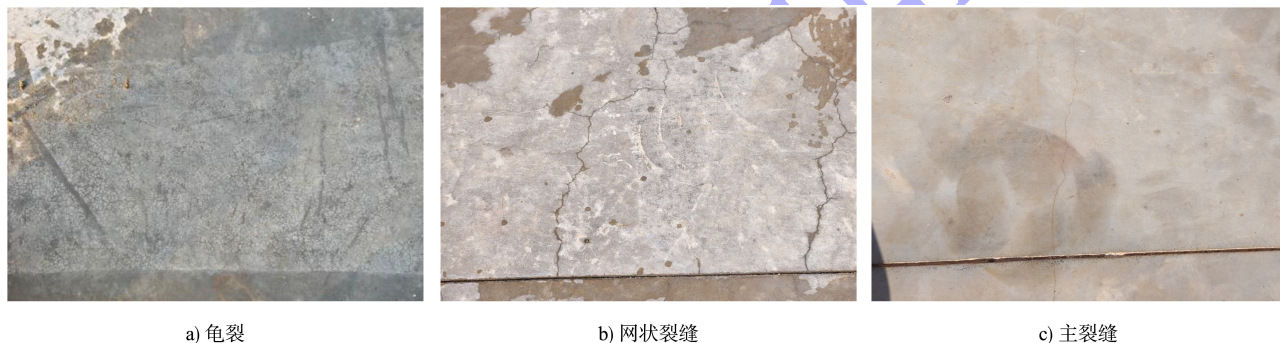
图 4 码头面层混凝土裂缝形式
