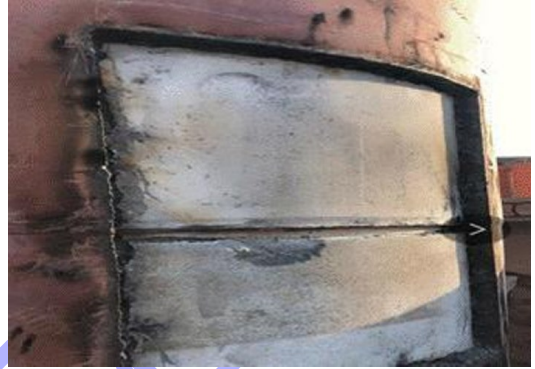
图 6 钢套筒剥开灌浆料的外观
